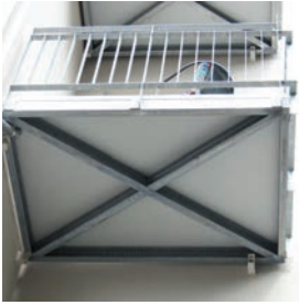
12097 Sanierung Hoffassade Kirchenweg, Kiel Die 3-Punkt-Lagerung der Balkon- kone machen eine Abstützung verzichtbar.
